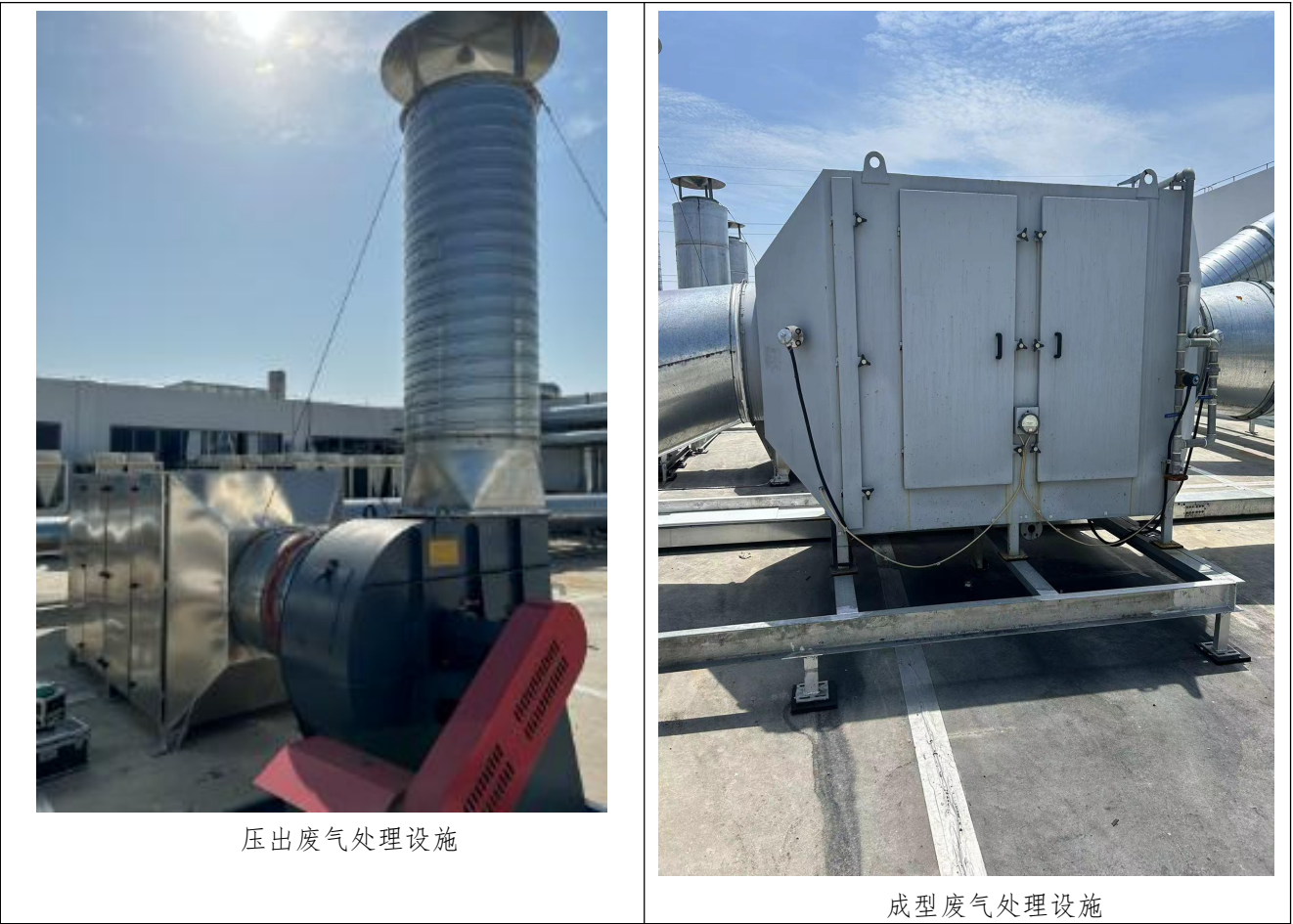
图3-1 废气处理设施图片
