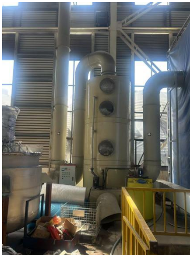
钝化废气处置设施
